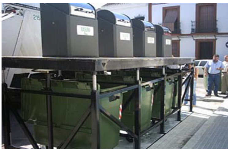
Εικόνα 66: Σύστημα υπογειοποίησης τεσσάρων κάδων
